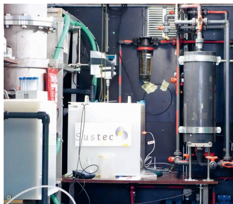
Produire de l'électricité à partir du biogaz obtenu par fermentation des boues d'épuration grâce à Horizon 2020. (Photo: Eawag)
