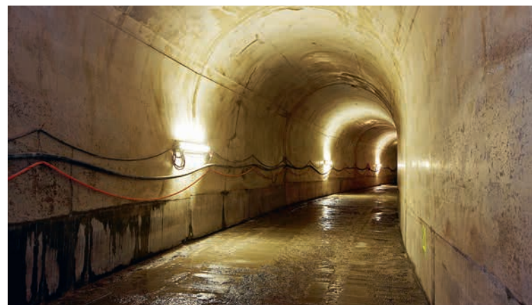
Une galerie de déviation près de Tiefencastel transporte les dépôts de charriage en aval en cas de crue. (Photo: ewz-Medienarchiv/Matthias Kunfermann)
