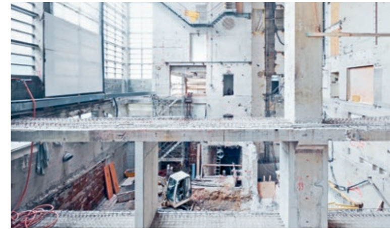
Le laboratoire des machines / centrale de chauffage urbain (ML / FHK) de l'ETH Zurich au centre de la ville – une rénovation soumise aux contraintes strictes de protection du patrimoine. » Luca Zanier / ETH Zurich
